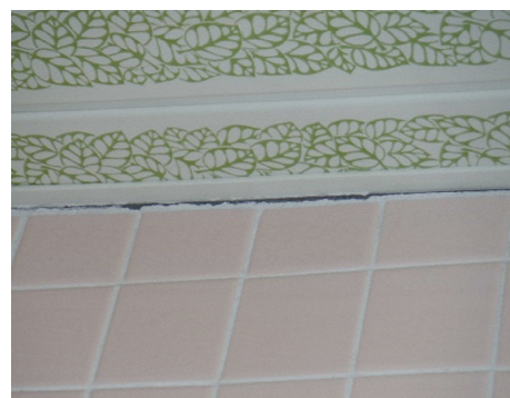
③浴室天井と壁の間に割れ目
