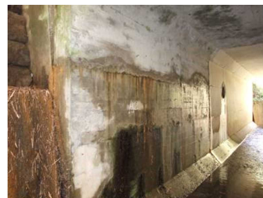
漏水・遊離石灰
