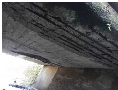
剥離・鉄筋露出
