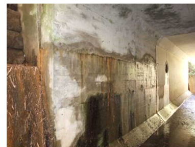
漏水・遊離石灰
