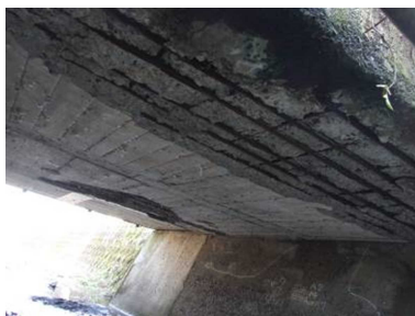
剥離・鉄筋露出
