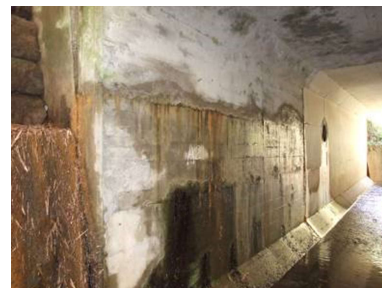
漏水・遊離石灰
