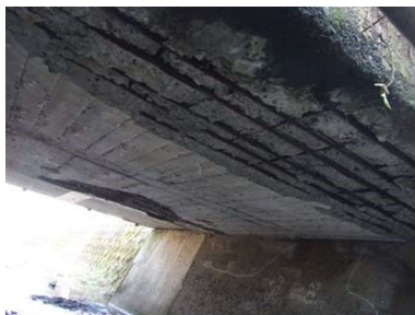
剥離・鉄筋露出
