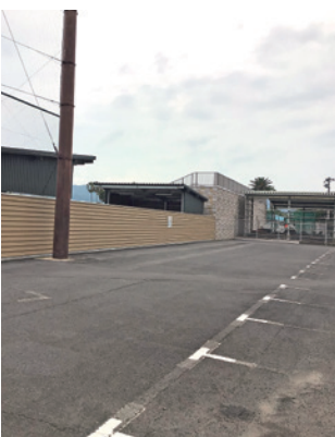
防球ネットの未設置部分
