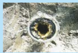
スケールが付着した温泉配管
