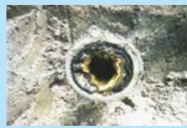
スケールが付着した温泉配管
