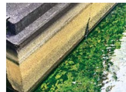
水路の側面や底が温泉成分で変色している
