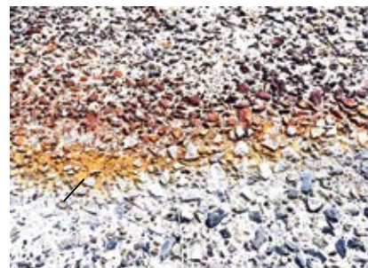
温泉水路の近くの道路は白くなり、 錆びたように変色している
