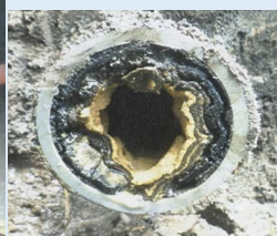
スケールが付着した温泉配管
