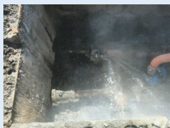
漏湯している温泉配管
