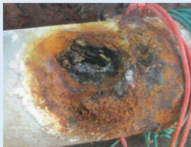
湯之里配湯施設 送湯ポンプ配管
